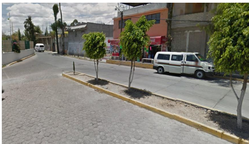
Vista de calle Gaseoducto, donde se aprecia el material actual que es adoquín y concreto hidráulico con camellón en mal estado.
