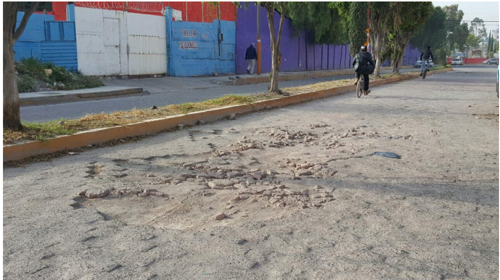
Baches en tramo con adoquín en calle Gasoducto.
