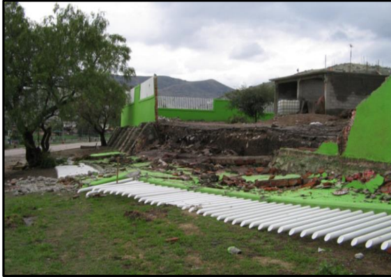
Foto: Derrumbe hacia el interior del Parque Bicentenario.
