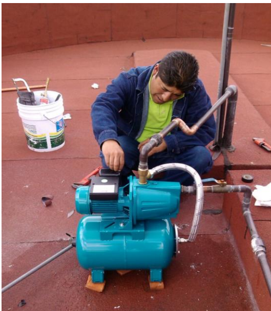
Mantenimiento de bomba hidroneumática, UES La Paz
