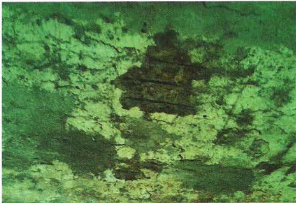
Techo húmedo, colgado y varillas descubiertas
