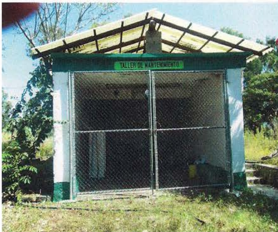
Bodega con techo de lámina deteriorado
