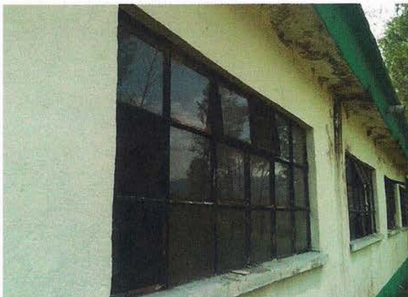
Marquesina dañada por la humedad
