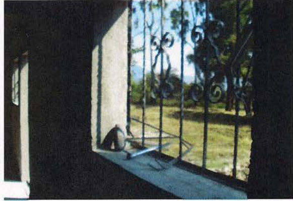
Emboquillado de ventanas sin retirar herrería útil
