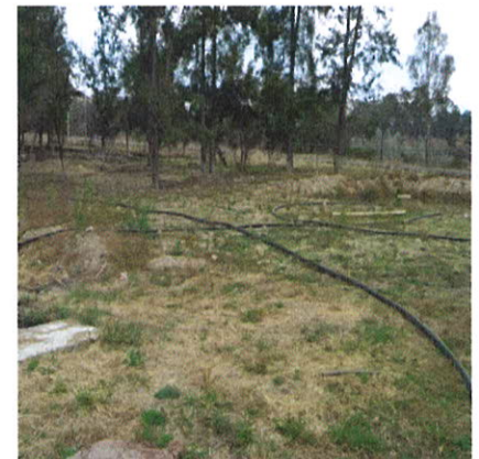
Red de agua provisional
