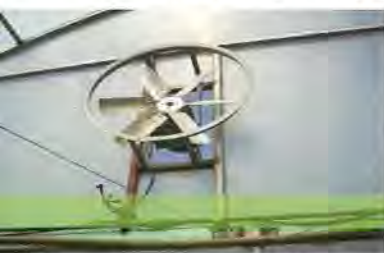
Figura 3. Ventiladores y extractores artificiales
