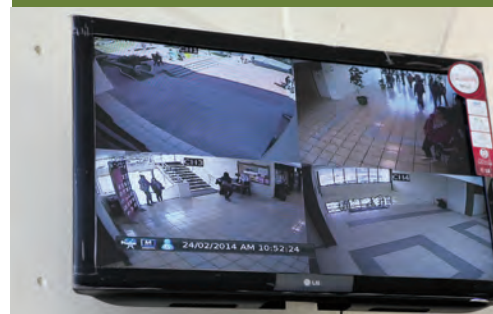
Para garantizar la tranquilidad de la comunidad se amplían las medidas de seguridad del Centro Universitario UAEM Ecatepec con la operación de 10 cámaras de videovigilancia, instaladas en áreas estratégicas.
