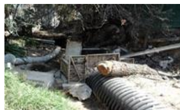
Colector Combinado México Nuevo
