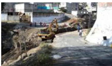
Construcción de puente y colocación de tubería Col. Rinconada Alfredo B. Bonfil
