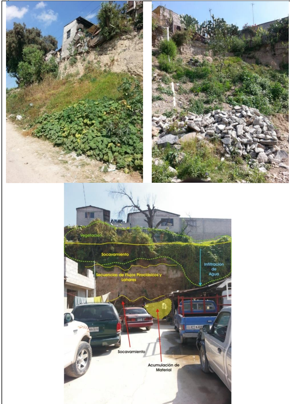
Figura 4.2 Taludes Inestables en la Colonia Ciudad Cuauhtémoc (Zona Sierra de Chiconautla).
